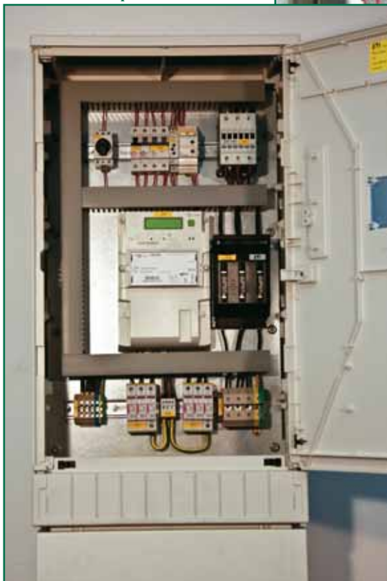
Rozdzielnica pomiarowa AC
