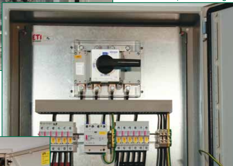
Rozdzielnica DC (wkładki CH gPV)
